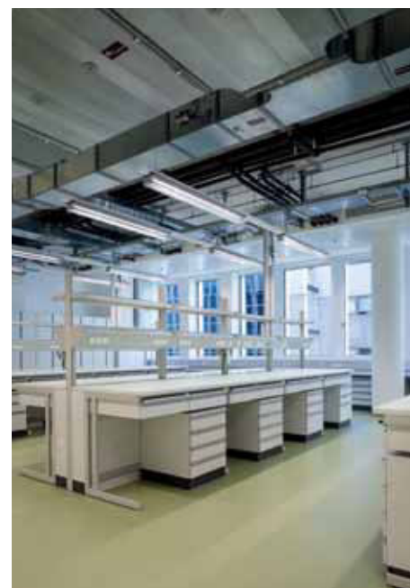
Die Decken sind im Bereich der Labore offen, sodass die Installationen frei sichtbar sind.
